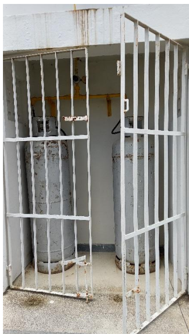
Barreira de proteção às botijas ficam abertas.
