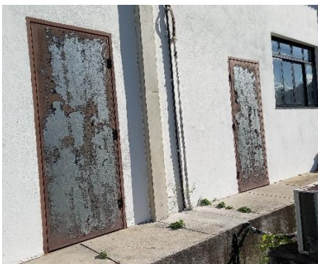
Portas de saída de emergência depreciadas no bloco C – Eixo 1
