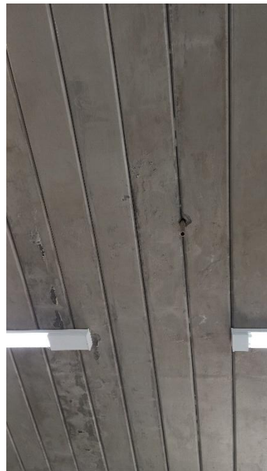
Sinais de infiltração no forro do teto
