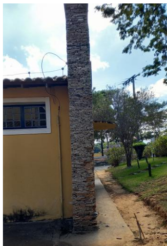
Pedras soltando no Prédio Multiusuário 2
