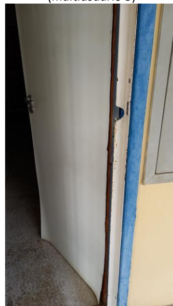
Porta danificada prédio da madeira
