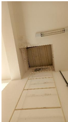
Sinais de infiltração no alçapão e paredes do prédio da Administração.
