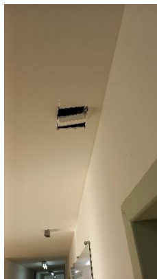
Buraco no gesso do teto do corredor com risco de cair um pedaço
