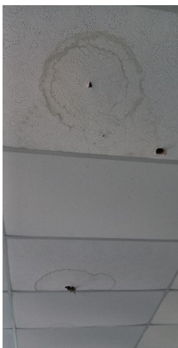
Sinais de infiltração no teto acima do público
