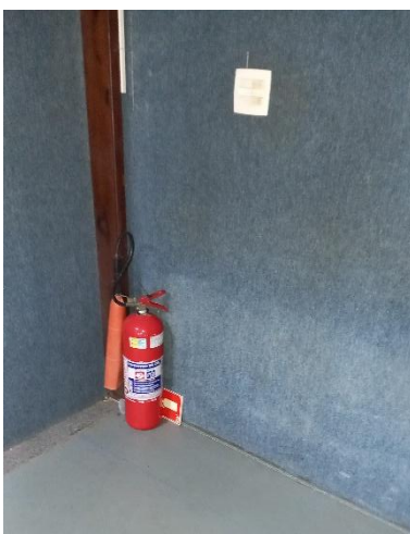
Extintor no chão do auditório
