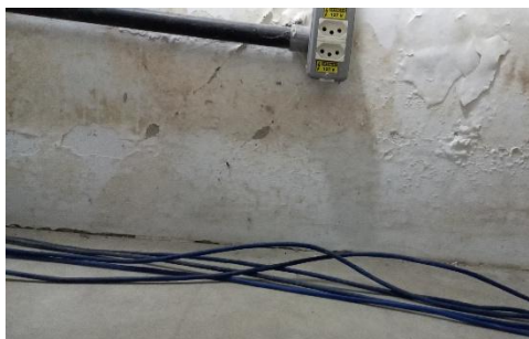
Sinais de infiltração na parede do Lab. de Redes e Telecomunicações
