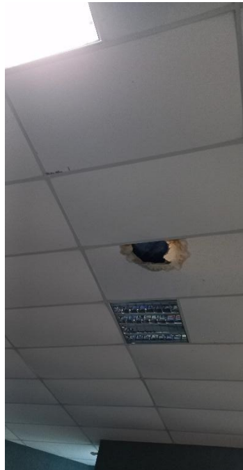
Forro quebrado aparentemente devido à infiltração
