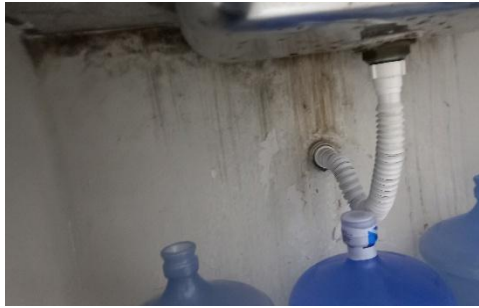
Sinais de vazamento na pia da copa – Bloco F, Eixo 3
