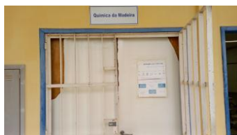
Porta danificada prédio da madeira
