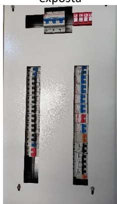
Disjuntores sem identificação
