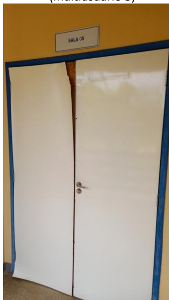
Porta danificada no prédio da madeira
