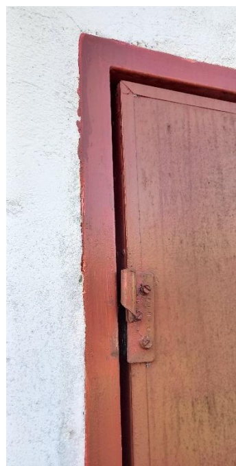
Lab. Ecologia – Porta saída de emergência quebrada
