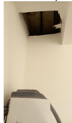
Sinais de infiltração e ausência da parte do gesso no teto do bebedouro no piso superior
