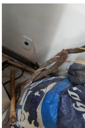
Improvisado de fiação em tomada, ficando exposta e próximo à madeira seca
