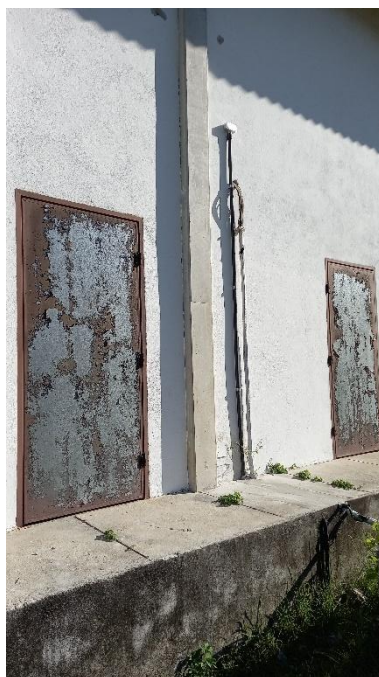
Eixo 3 – Porta de saída de emergência dpreciadas
