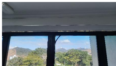
Janela se vedação superior favorecendo infiltração da água da chuva.
