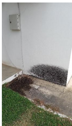
Trincas e lodos nas paredes externa. Dreno do ar-condicionado caindo no passeio
