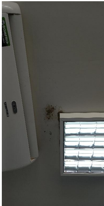
Sinais de infiltração no teto do Lab Mar
