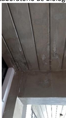
Sinais de infiltração no teto do corredor e mofo
