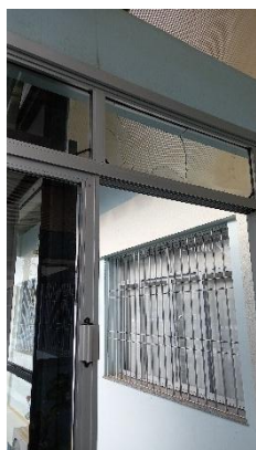
Vidro do hall de entrada quebrado
