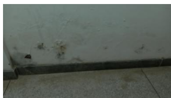
Sinais de infiltração e mofo na Subprefeitura
