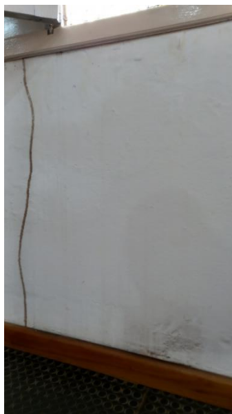
Rastro de cupim e sinais de infiltração na biblioteca
