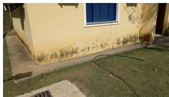
Fachada depreciada (multiusuário 3)
