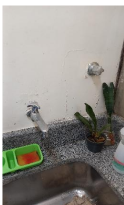
Sinais de infiltração na parede da pia e atrás da geladeira no Laboratório de Biologia
