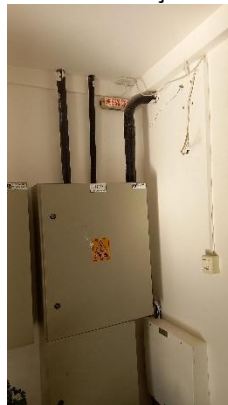
Fiação desencapada e exposta
