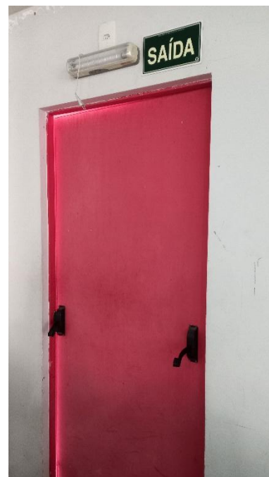
Maçaneta da porta de emergência quebrada
