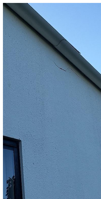
Parede trincada e tinta soltando no Bloco E – Eixo1
