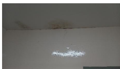
Trincas na parede e sinais de infiltração no teto
