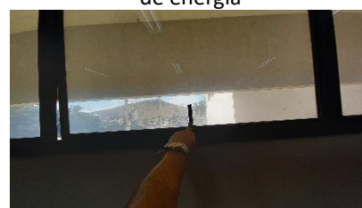
Janela com defeito, não abre.
