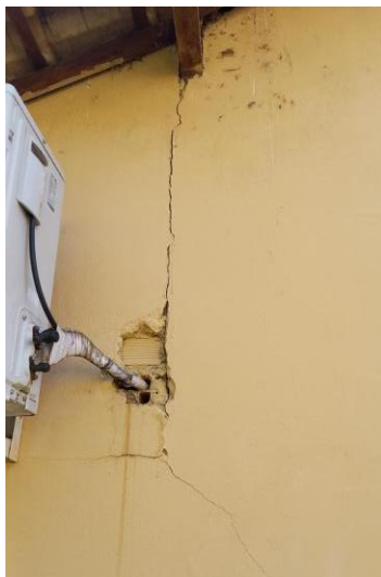
Fissuras na parede do Complexo Laboratorial de Silvicultura e Ecologia Florestal
