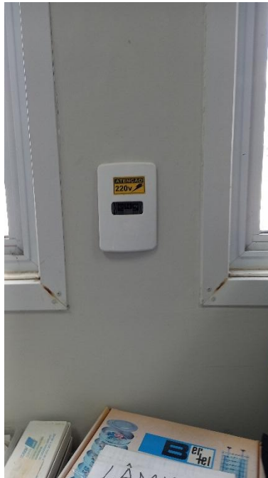
Tomadas que não funcionam no Lab Mar
