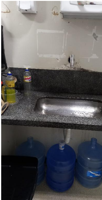
Sinais de vazamento na pia da copa – Bloco F, Eixo 3
