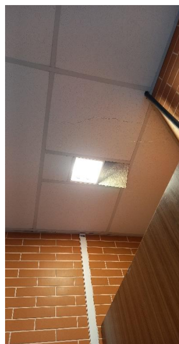
Parte do forro soltando e forro trincado
