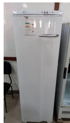
Freezer se patrimônios 802002 e 803581 queimados devido à variação de energia
