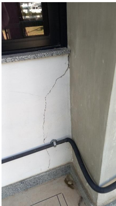
Rachadura espessa na parede externa na varanda do prédio
