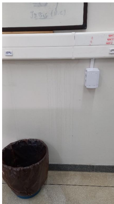
Lab. de Eletrônica - Sinais de infiltração de água da chuva
