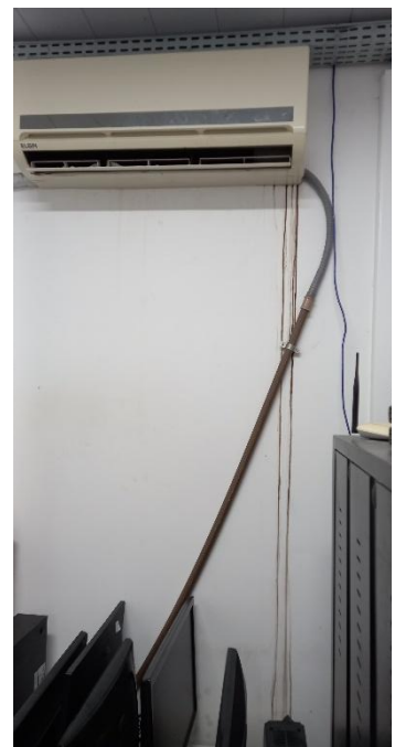
ar-condicionado vazando água, escorrendo na parede no Lab. de Redes e Telecomunicações
