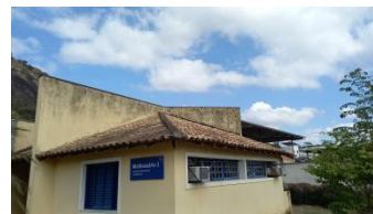
Fachada depreciada (multiusuário 3)
