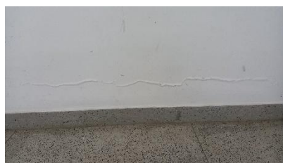
Sinais de infiltração nas paredes
