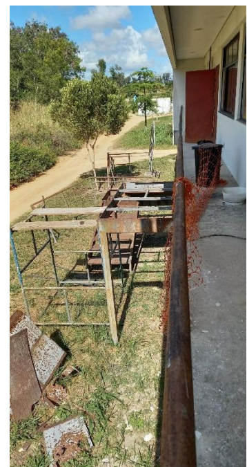
Lab. de eficiência energética 2 - escada e emergência com defeito
