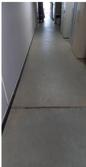
Abertura no chão do corredor do bloco C – Eixo 1
