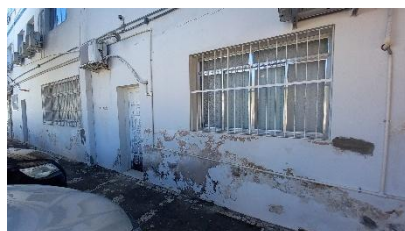
Fachada com trincas e depreciada, descascando.
