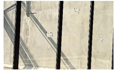
Rachadura na parede externa do prédio da Administração.
