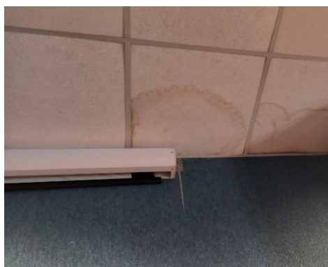
Sinais de infiltração no forro do teto do palco
