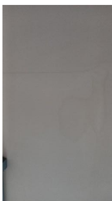
Sinais de infiltração no teto do corredor e em outros pontos do prédio adm
