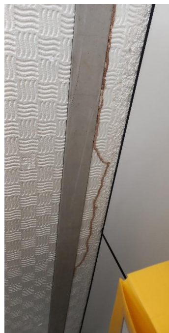
Rastro de cupim no almoxarifado
