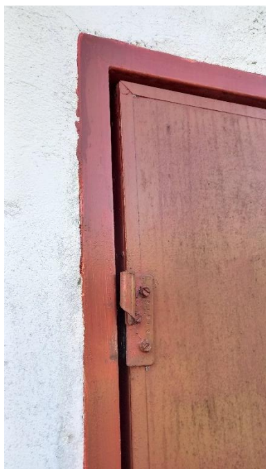
Eixo 3 – Porta de saída de emergência danificada
