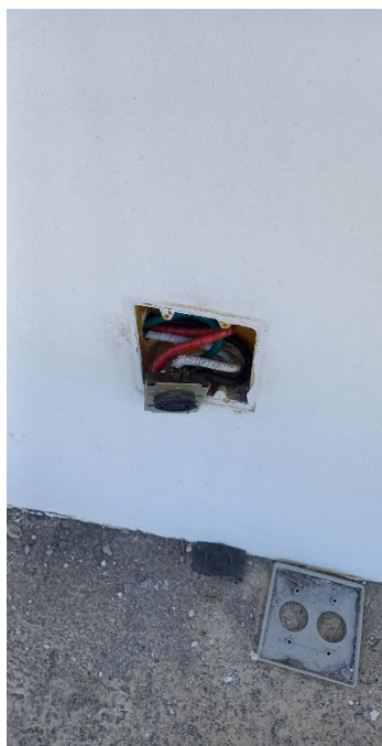
Tomada danificada no Bloco D - Eixo 4
