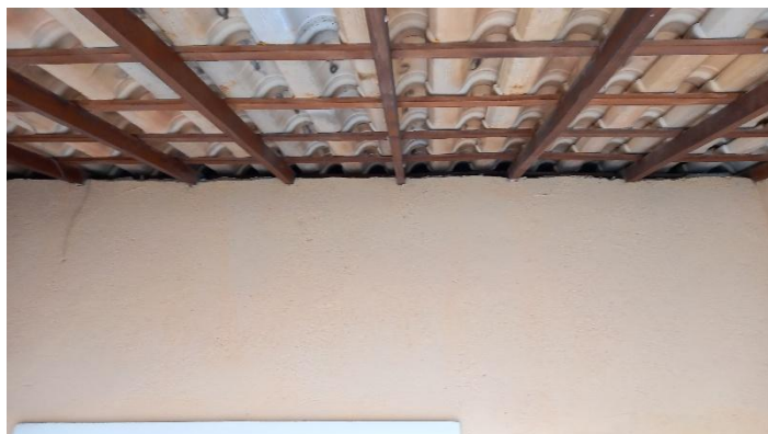
Fresta do telhado propiciando a entrada de morcego
