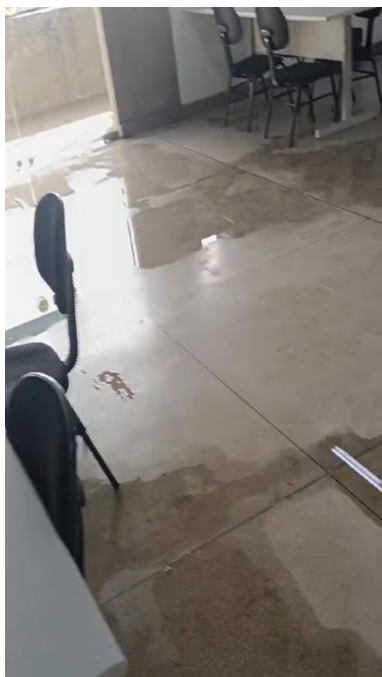
Infiltração de água da chuva pela varanda superior 4
