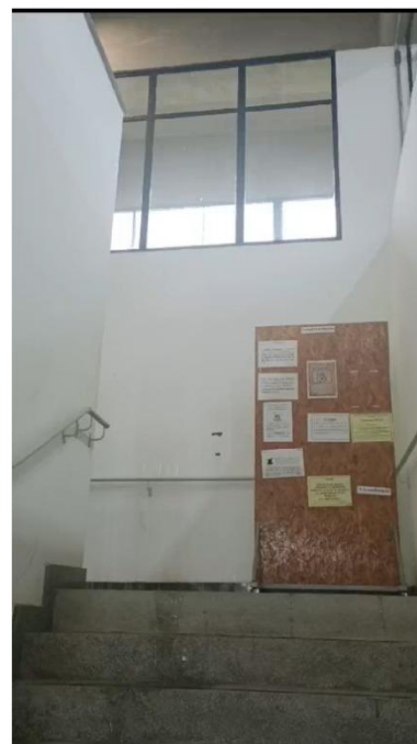
Infiltração de água da chuva escorrendo pela escada 4
