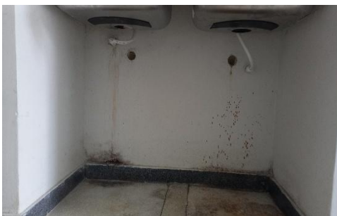
Pias sem sifão, inutilizadas no Lab. de Química Geral e Inorgânica
