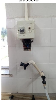
Tomadas sem o espelho e fiação exposta
