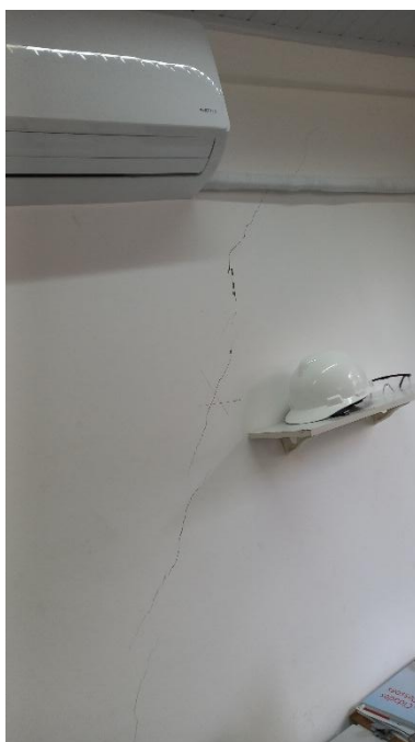
Trinca na parede da subprefeitura
