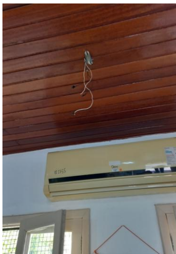
fiação exposta na biblioteca
