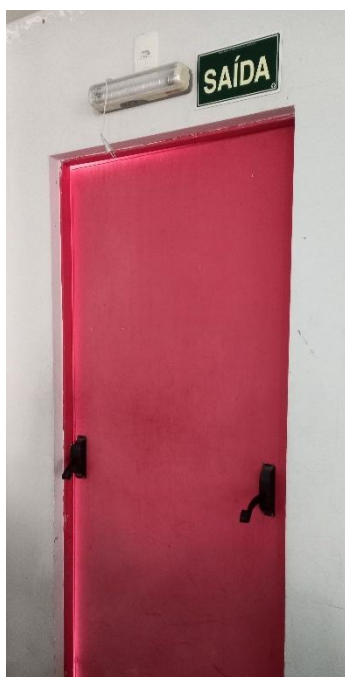
Sala 14 - Porta de saída de emergência danificada
