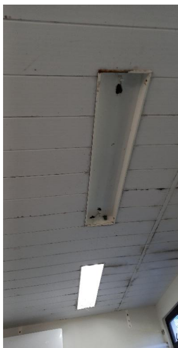
Ausência de lâmpada e forro mofado, sinais de umidade no Laboratório de Zoologia Invertebrados
