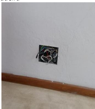
Fiação exposta no prédio Multiusuário 2
