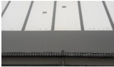
Trincas na parede do corredor do prédio da Administração.
