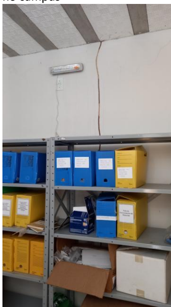
Rastro de cupins no almoxarifado
