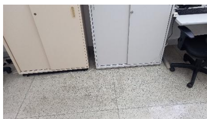
Escassez de tomadas, improviso de extensão pela sala com vários aparelhos ligados em uma só tomada com adaptador.
