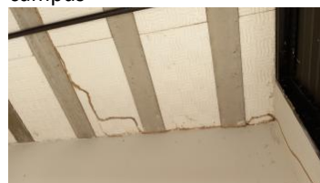
Rastro de cupins no almoxarifado
