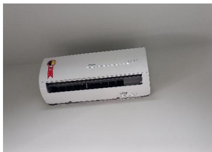
Ar-condicionado quebrado no Lab. De Ecofisiologia de manguezais
