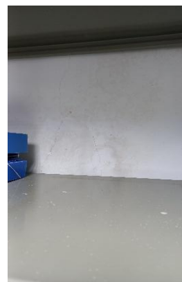
Infiltração na sala 10, provavelmente do banheiro feminino ao lado (foi solicitado reparo em 1/09/2023. Solicitação - 79568
