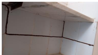
Rastro de cupim no banheiro da biblioteca
