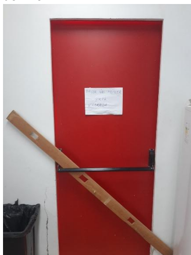
Porta de saída de emergência Danificada
