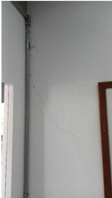
Trinca na parede interna soltando pedaço da tinta/reboco
