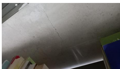
Trincas em paredes
