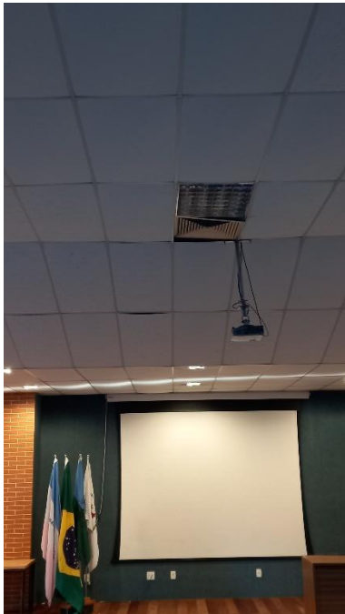
Tampa do ar-condicionado soltando.
