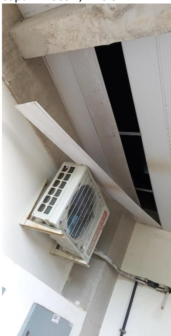
Forro solto com risco de cair em algum usuário no Bloco F - Eixo 3
