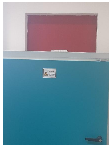
Saída de emergência obstruída
