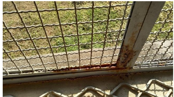
Rampa de acesso com corrosões (ferrugens), galhos de árvores adentrando à passagem e buraco aberto para elevador acessível aparentemente abandonado.
