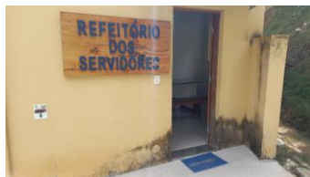
Fachada do refeitório depreciada
