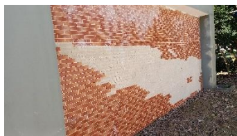
Revestimento soltando da parede no Eixo1
