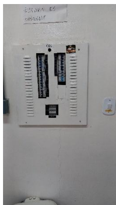
Disjuntores sem identificação
