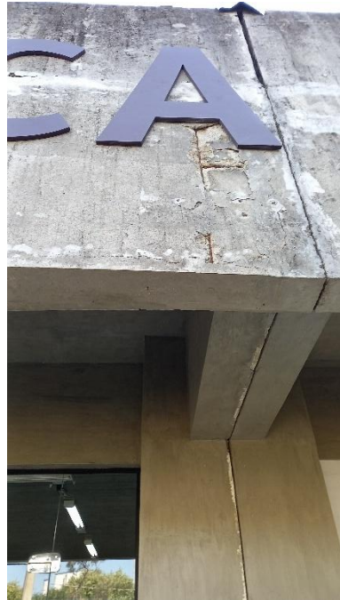
fachada degradada com exposição de ferro da armadura
