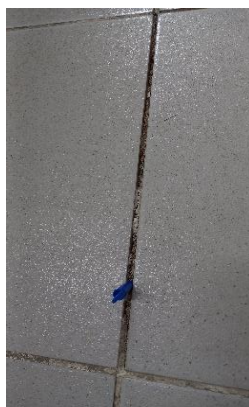
Pisos soltos e sem rejunte podendo ocasionar tropeços e quedas.
