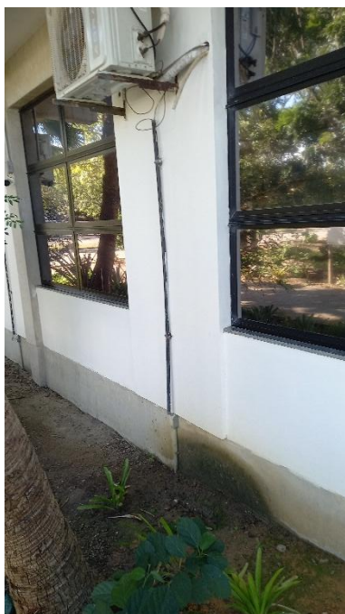
Dreno do ar-condicionado gerando umidade na parede
