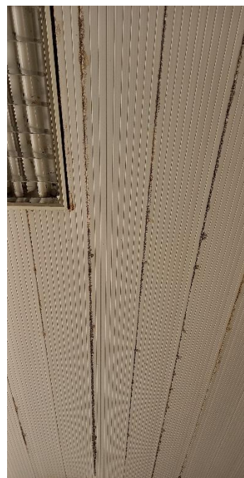
Corredor com sinais de infiltração no forro e luminárias enferrujadas no bloco C – Eixo 3
