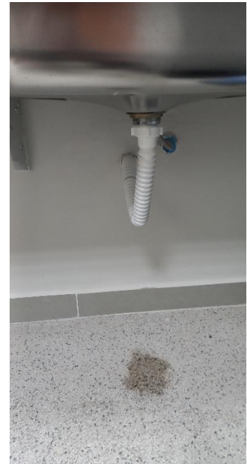
Vazamento na pia do Lab. De Ecofisiologia de manguezais
