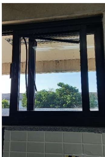
Janela quebrada com vidro solto, sem as juntas. Bloco B - Eixo 1
