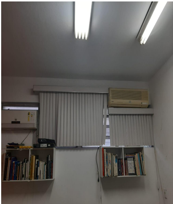
Imagem 8 – Sala com ventilação inadequada
