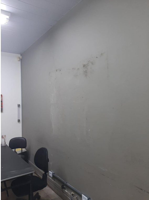
Imagem 5 – Sala com sinal de infiltração
