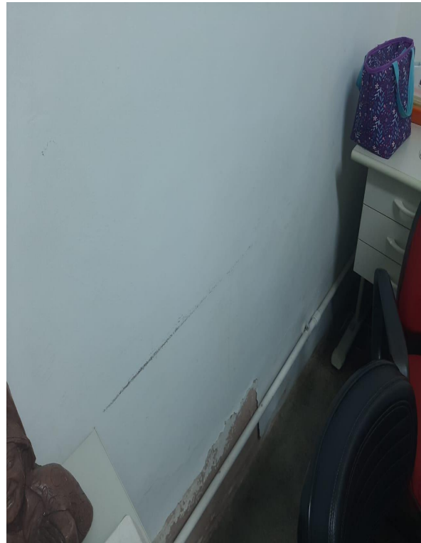
Imagem 6 – Sala com rachadura
