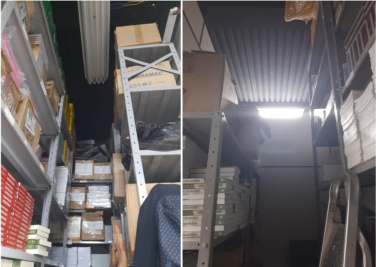
Imagens 3 e 4 – Estoque localizado dentro do ambiente administrativo da Edufes, com vão entre parede e telhado
