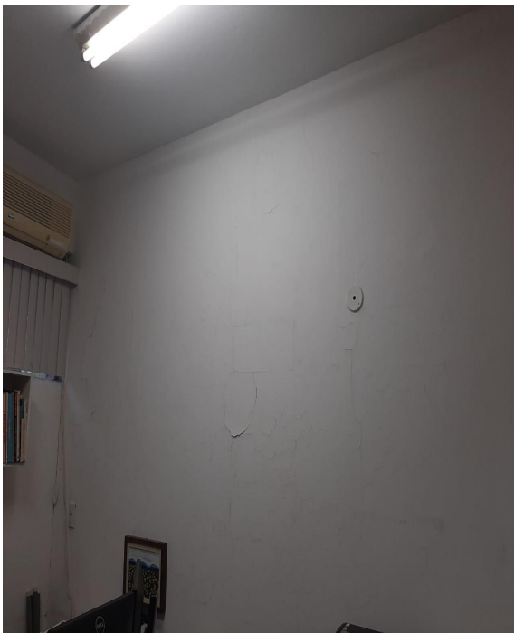
Imagem 7 – Sala com rachadura
